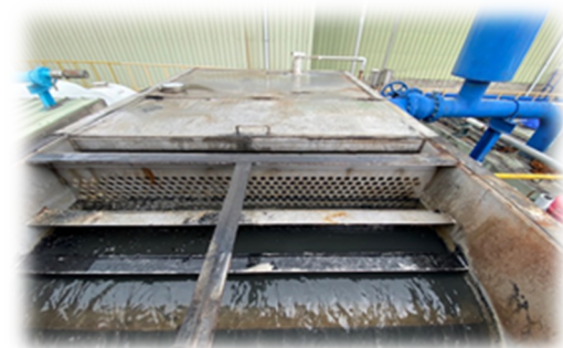
廢水處理前端槽內設有過孔阻隔
