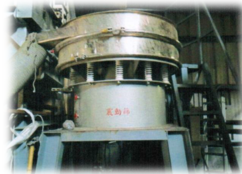
廢水處理設施前端設有震動篩
